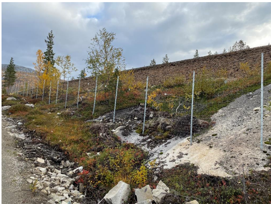
Figur 6-1 Sikringsgjerde som er bygd nord for Lønsdal stasjon.
