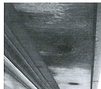
Bilde 1: Undersiden av en takkasse. Det er ikke slik det skal se ut!
