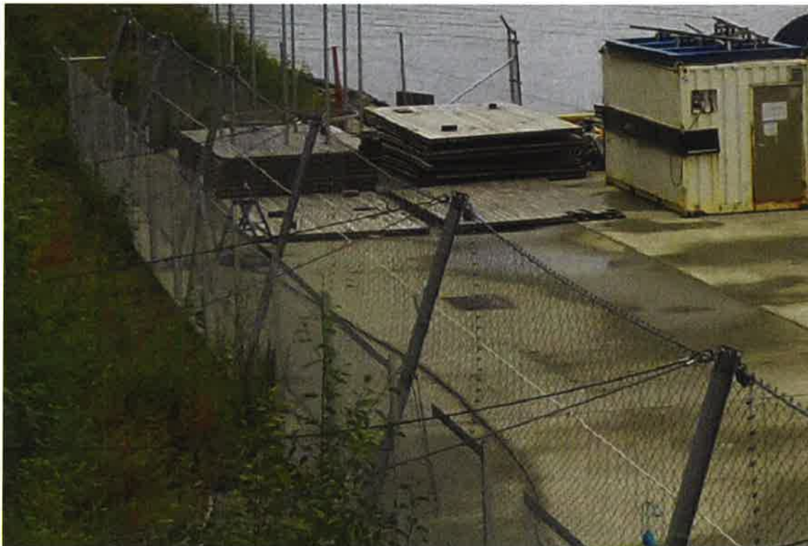
Figur 2-9 Rassikringsnett i bakkant av siste byggetrinn.
