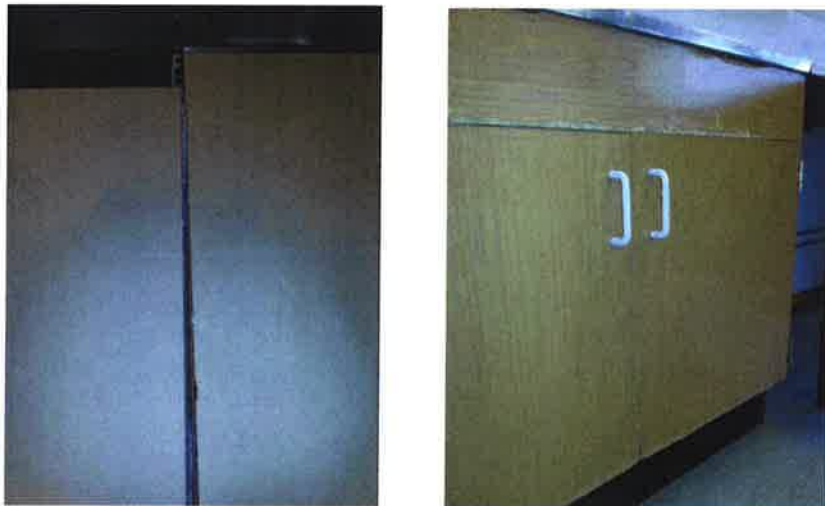
BILDE 9: SKAPENE ER ØDELAGTE OG MYE MATRESTER MELLOM BENKPLATENE
