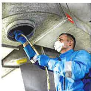
BILDE 5: RUTINEMESSIG RENGJØRING ER VIKTIG FOR HELSE OG FUNKSJON.
