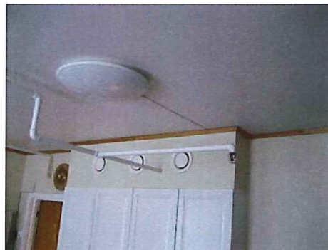
Bilde 1 Feil høyde på sprinkler
