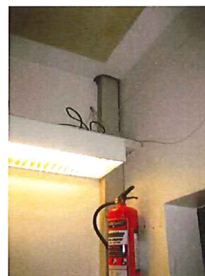
Bilde 12 Manglende branntetting
