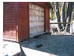
Bilde 43 Fundament mangler
