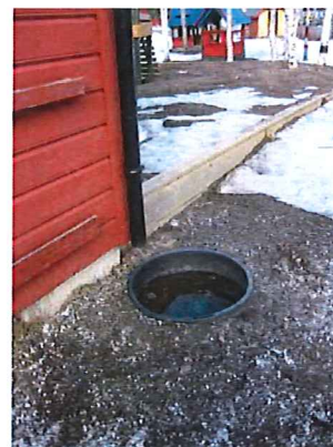
Bilde 5 Dårlig løsning på synkekum
