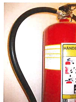
Bilde 24 Alle brannslukningsapparater mangler godkjenning i kommunen.
