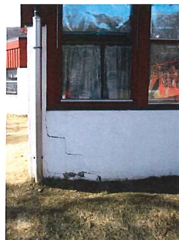
Bilde 4 Fundament i bevegelse.
