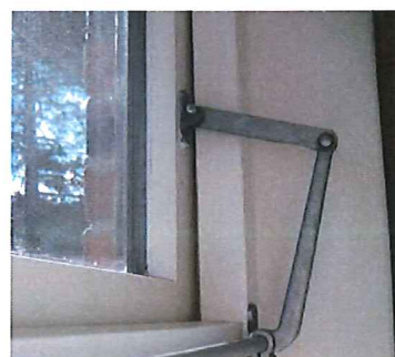
Bilde 16 Ingen vinduer tetter ordentlig!
