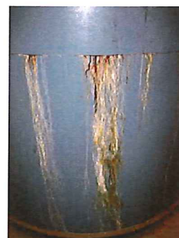
Bilde 22 Varmvannstank er i ferd med å ryke.
