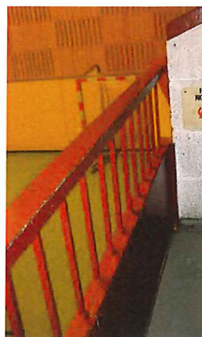
Bilde 27 Rekkverket må forhøyes i henhold til vedtekter!
