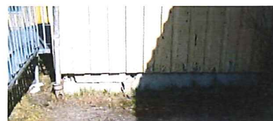
Bilde 11 Ødelagt fundament
