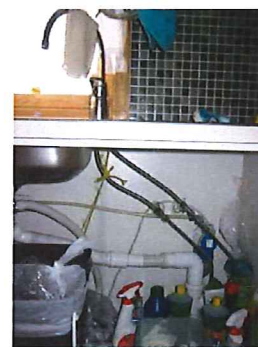
Bilde 7 Feil plassering av vannrør!
