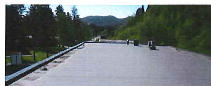
Bilde 37 Taket ble berget, nå må resten berges!
