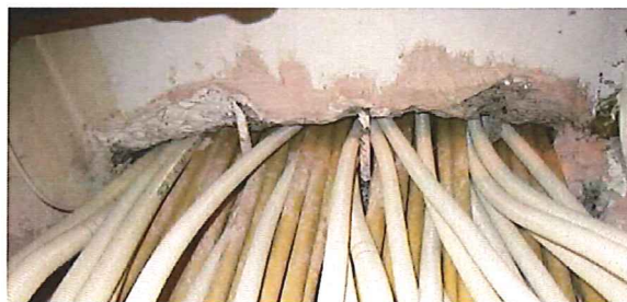
Bilde 19 Manglende branntetting.
